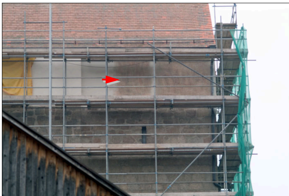
ABBILDUNG 3. Südfassade, Ostecke: Farbmuster für die Gestaltung des oberen Putzbandes, hier ungefähr in Bildmitte (siehe Pfeil)
