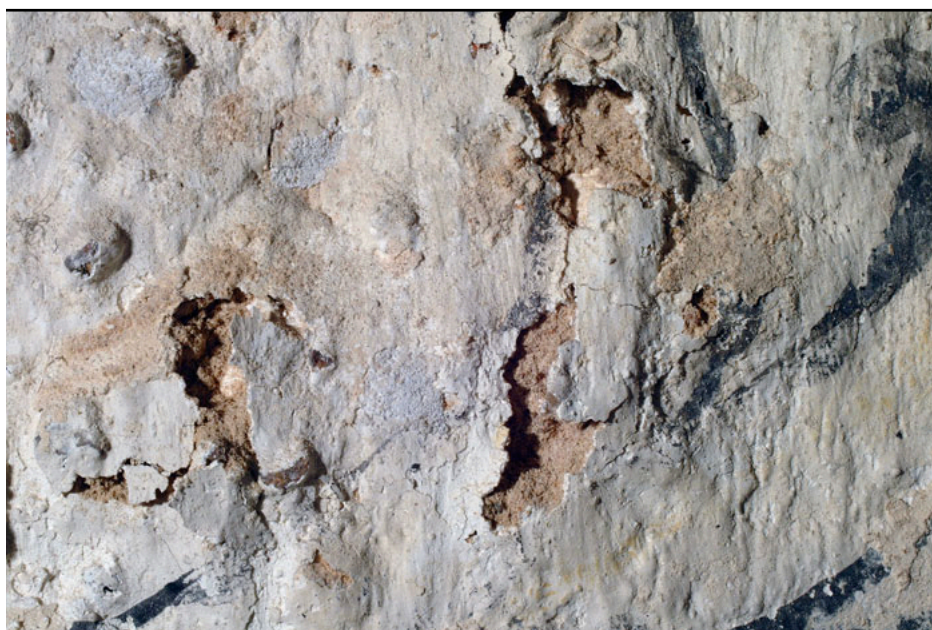
ABBILDUNG 7. Chorraum, Südwand: Bereich mit folieartig aufliegender und akut geschädigter Malschicht - das Schadensbild erforderte konservatorische Sofortmaßnahmen
