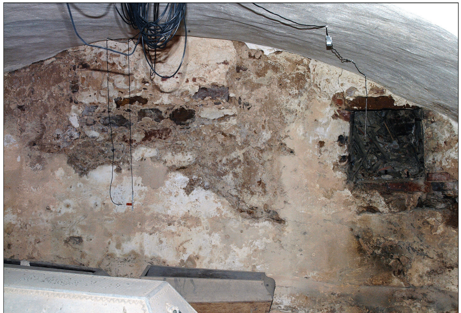
ABBILDUNG 7. Geschädigte Nordwand des Hauptraumes, Klimamessung
